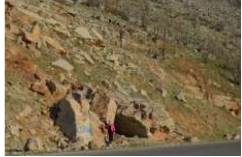
المصدر: الدراسة الميدانية، توضح منحدر بزاوية 45° الجناح الشمالي للطية و اثر كتل صخرية منهاره نتيجة عملية القص عند قمة المنحدر و حدوث ظاهرة الانزلاق الاسفيني ضمن تكوينات عقرة- بخمة.
